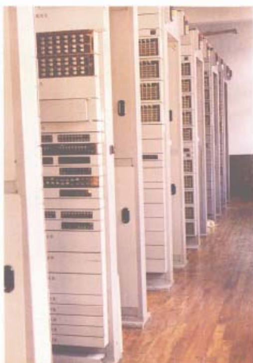
縱橫制自動電話交換機機房
